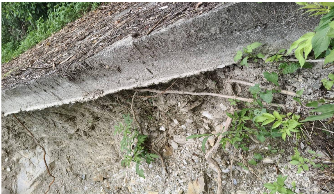
路基掏空約 10 餘公尺
