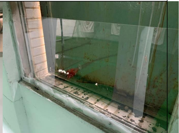
說明：雖有補黏，但仍破舊，且不耐用。
