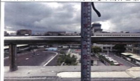
廁所走廊的欄桿高度不足 110CM 不符合現行規範標準
