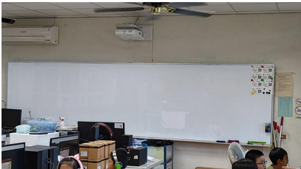
本校西側校舍二樓電腦教室白板變形且不具觸控電視功能
