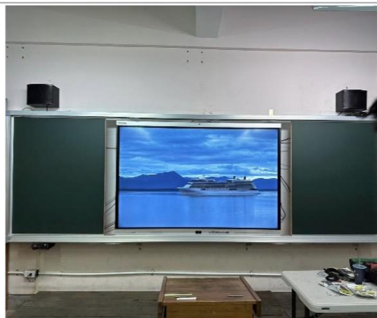
教室前方已安裝完智慧電視黑板現況-一年忠班
