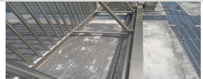
鐵軌磨損嚴重，經常脫軌非常危險
