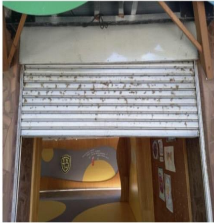
大門兩側鐵捲門現況-鐵門已歪斜
