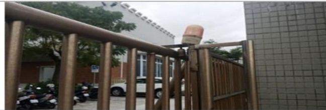
大門年久失修，結構多處變形損毀，且缺乏內外防夾撞設備，此外鐵門設計不良，開啟時容易碰撞行人。
