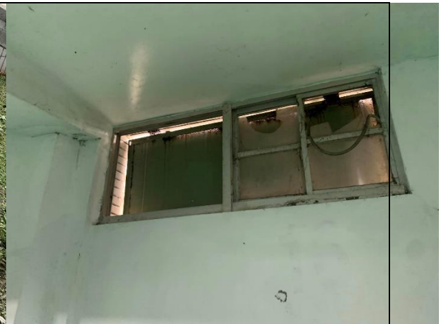
說明：氣窗外內部老舊
