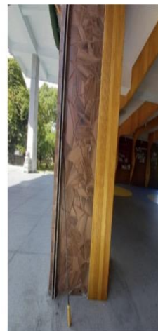
大門兩側鐵捲門現況-未裝設紅外線防夾裝置
