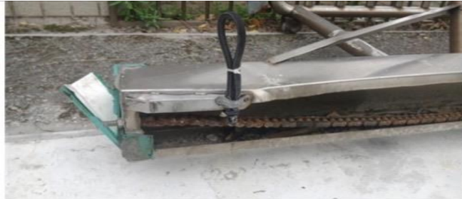
大門年久失修，結構多處變形損毀，且缺乏內外防夾撞設備，此外鐵門設計不良，開啟時容易碰撞行人。
