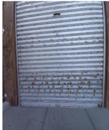
大門兩側鐵捲門現況-多處鏽蝕
