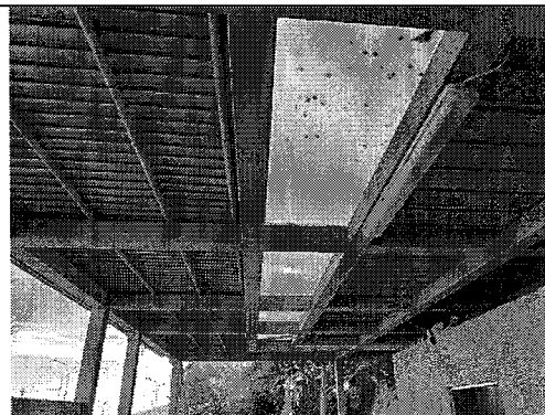
既有鋼棚鏽蝕、頂版浪板破損
